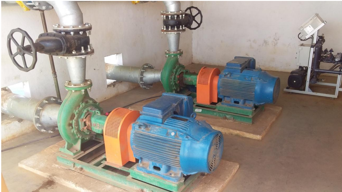
Figura 14 - Conjuntos eletro-bombas utilizados no projeto itaenga grande.
