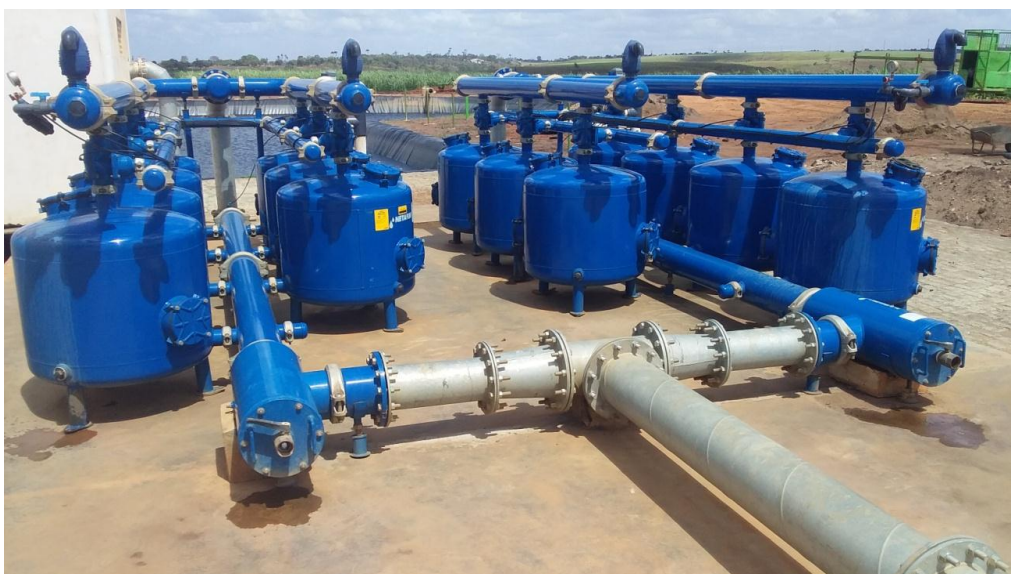
Figura 15 - Conjunto de filtros utilizados no processo de purificação da água utilizada na irrigação por gotejo.
