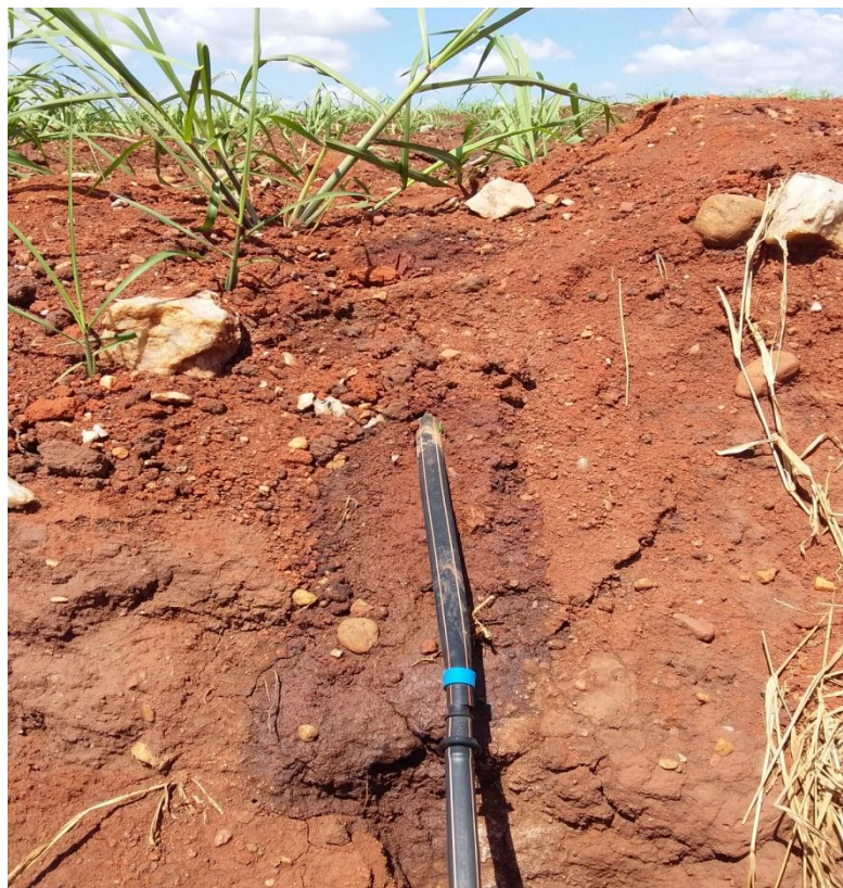
Figura 13 - Fita de gotejo instalada no fundo de suco.
