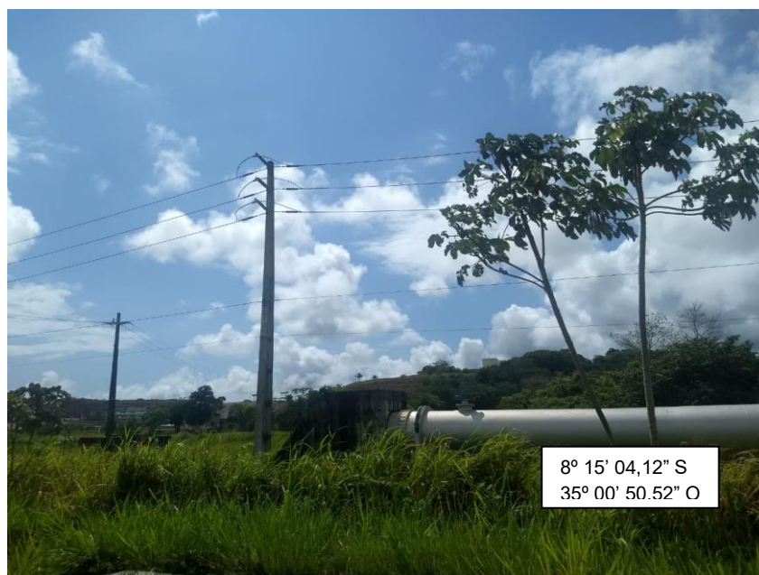
Figura 17 - Tubulação da Compesa sobre o Rio Gurjaú
