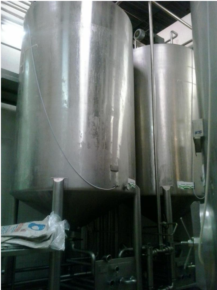
Figura 15: Tanques de mistura com volume de 8.000 L.
