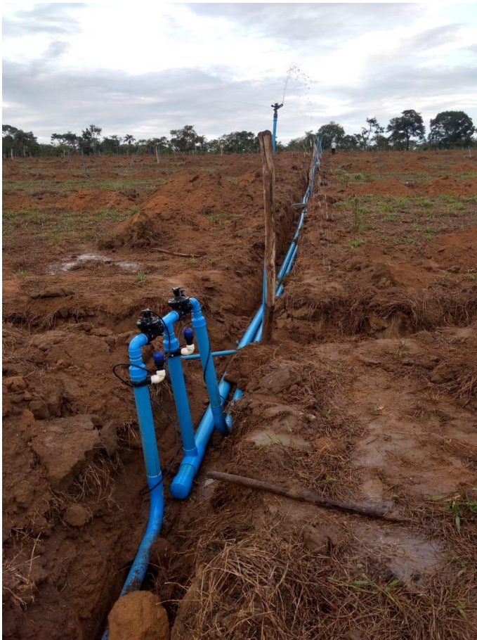
Figura 13 - Vista do ramal principal e cavalete para divisão dos setores.
