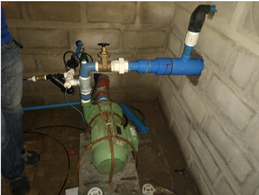
Figura 11 - Conjunto moto-bomba 7,5 CV
