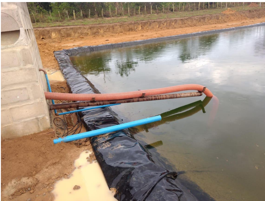
Figura 12 - Sistema de captação de água a partir da lagoa de armazenamento.
