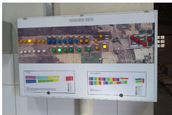
Figura 21 – Painel que permite o controle de todas as válvulas de irrigação.
