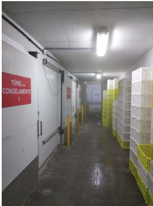
Figura 22: Tunel de resfriamento e congelamento
