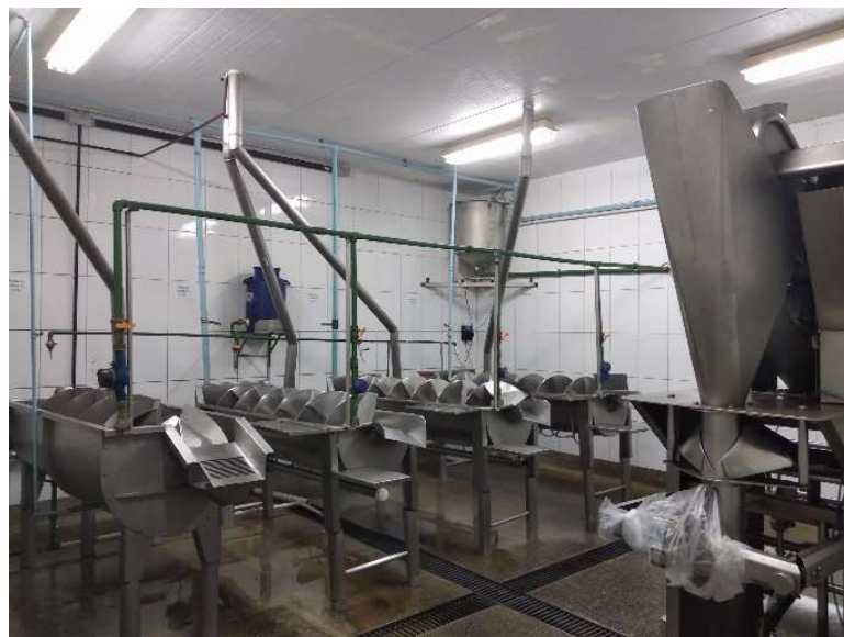
Figura 17: Chiller de miudos
