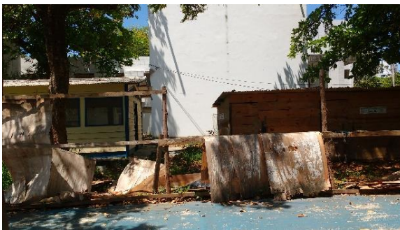
Imagem 31: estrutura- reforma inacabada
