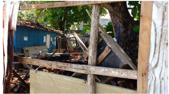
Imagem 28: estrutura- reforma inacabada
