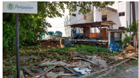
Imagem 32: estrutura- reforma inacabada
