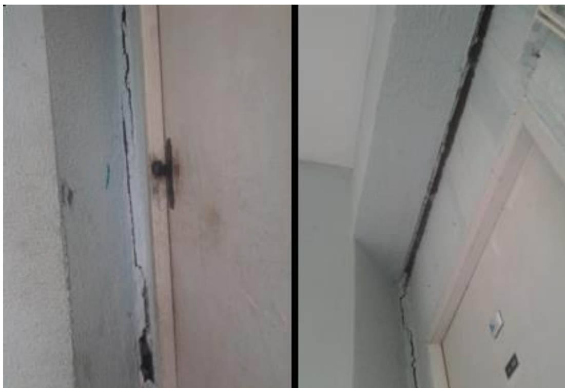
Figura X - Conjunto Habitacional com Problemas de infraestrutura
