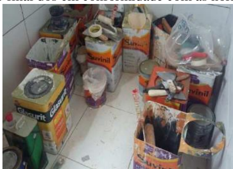
Figura 4. Resíduos sólidos da Classe D armazenados temporariamente no canteiro de obras para destinação final dos em conformidade com as normas técnicas específicas.
