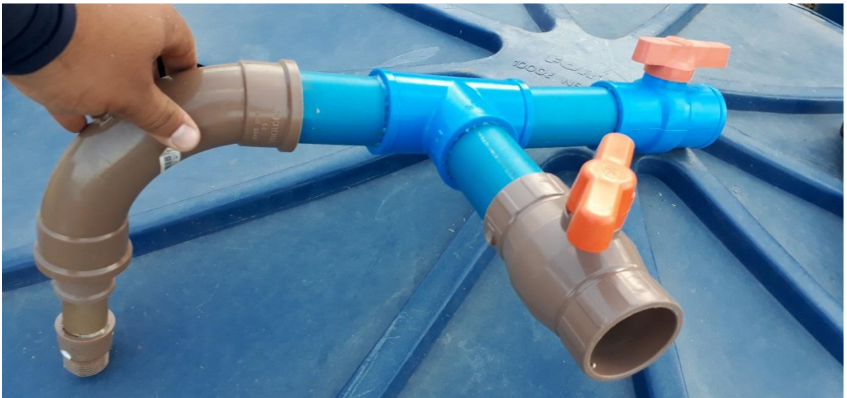
Figura 26. Conexões para sistema de recalque.
