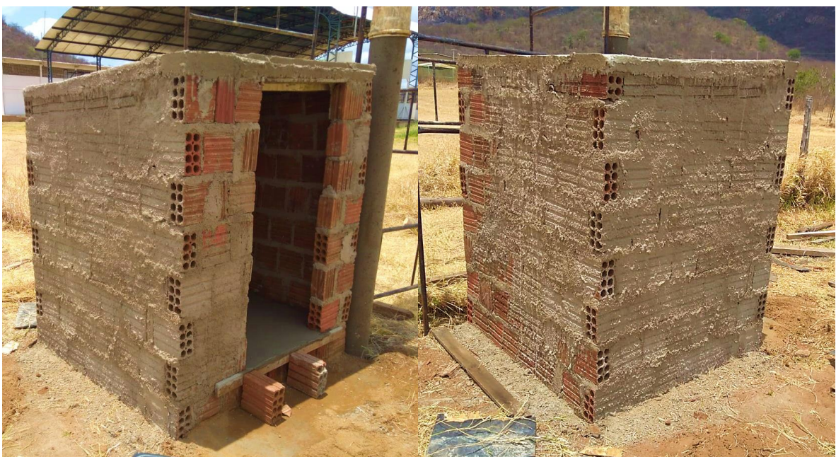
Figura 17. Abrigo para sistema motor bomba.
