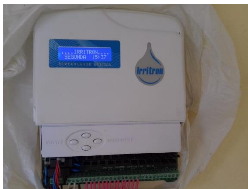
Figura 34. Central de automatização
