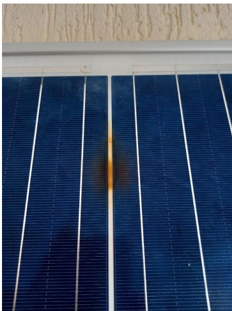
Figura 26 - Módulo com mancha causada por superaquecimento.
