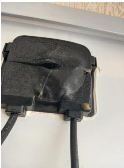
Figura 25 - Caixa de junção superaquecida.
