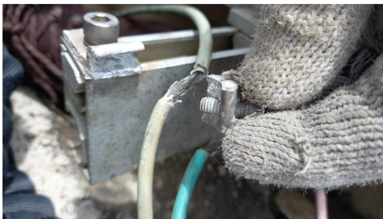
Figura 27 - Grampo de aterramento rompido.
