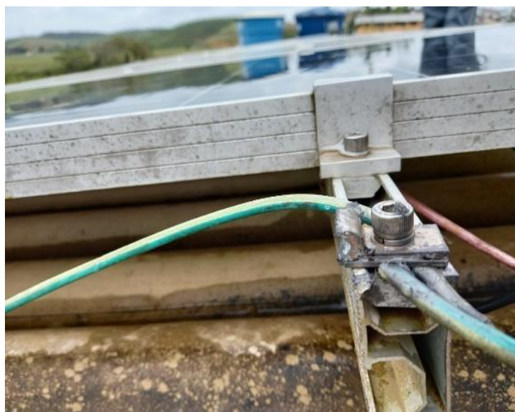
Figura 28 - Cabo de aterramento conectado na base do grampo de aterramento.
