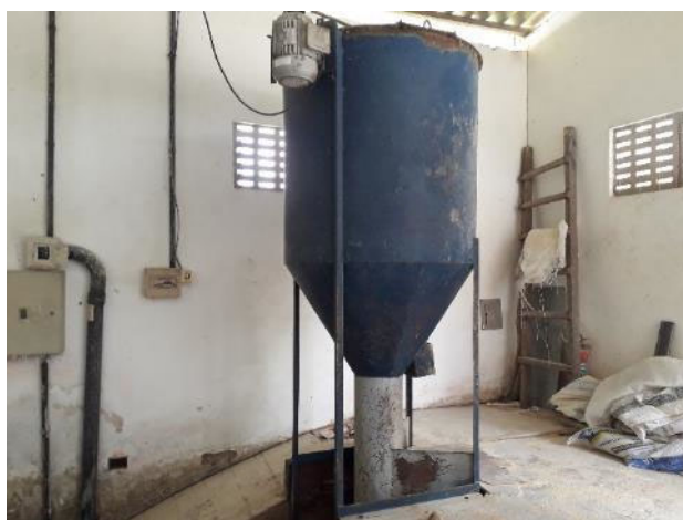
Figura 08: Misturador da fábrica da ração DZ – UFRPE.
