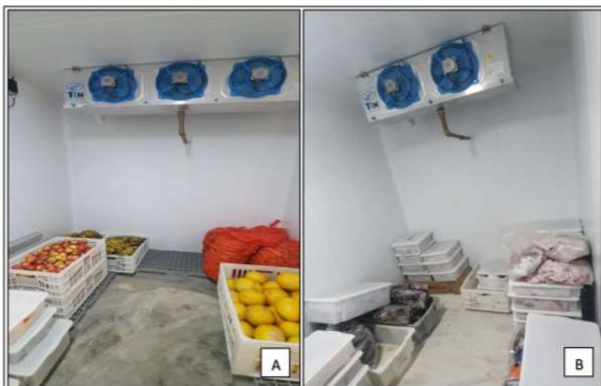
Figura 7. Seções da Câmara Fria do Setor de Nutrição do Parque Estadual de Dois Irmãos – Recife/PE. (A) Seção de Resfriamento da câmara fria e (B) Seção de Congelamento da câmara fria. Fonte: Arquivo Pessoal.
