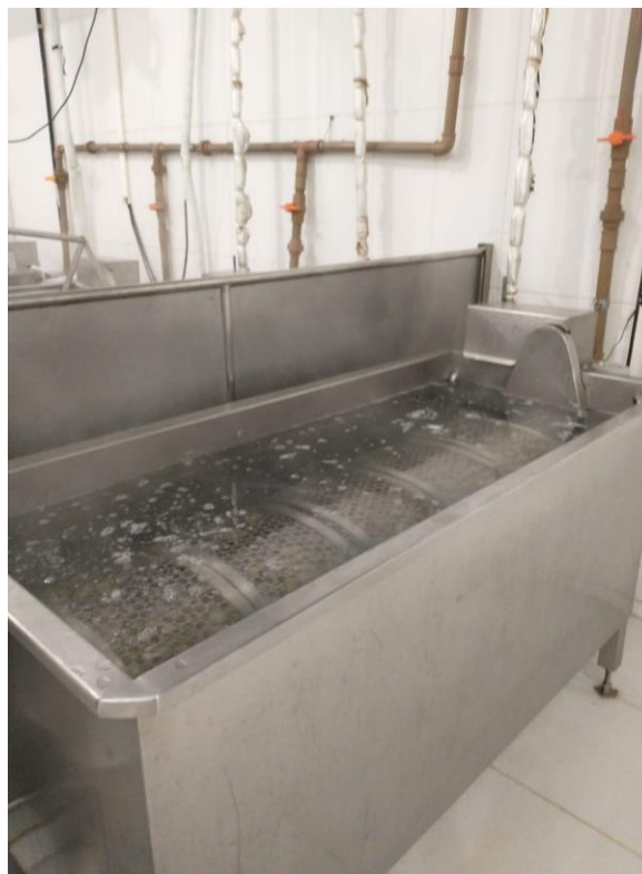
Figura 32. Tanque de centralização.
