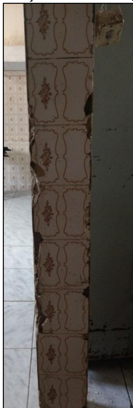
Figura 9: cerâmica quebrada na parede. Fonte: (Pinho, 2020).
