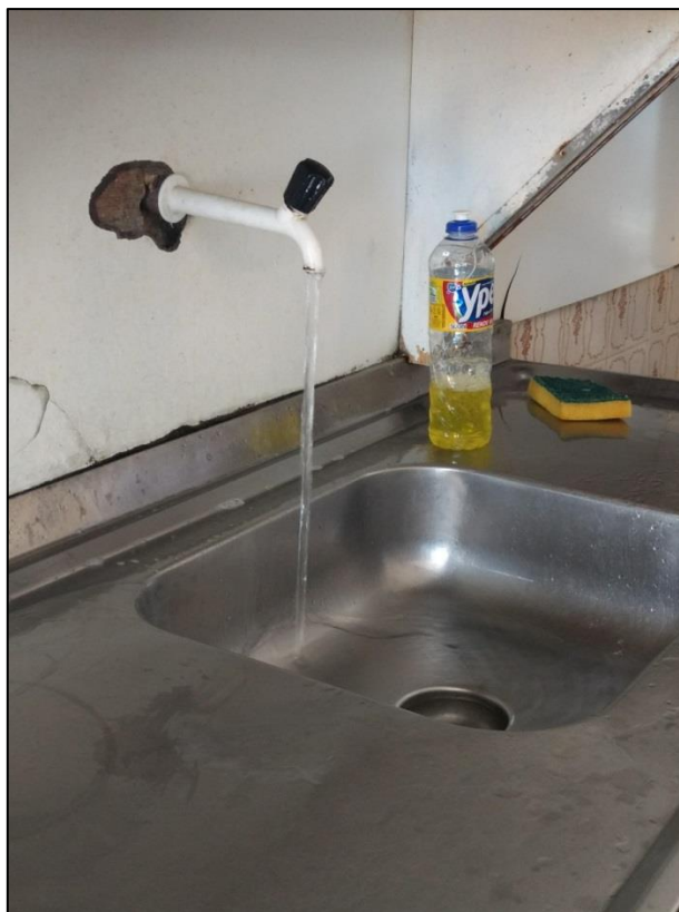
Figura 2: ausência de dispenser de sabonete e papel toalha descartável para higienização das mãos dos funcionários em pia de manipulação. Fonte: (Pinho, 2020).
