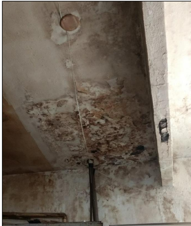
Figura 8: infiltração no teto. Fonte: (Pinho, 2020).
